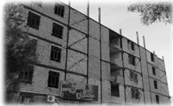
تصویر ۴-۱ نمونه فضای غیر قابل دفاع (ساختمان نیمه‌کاره)
